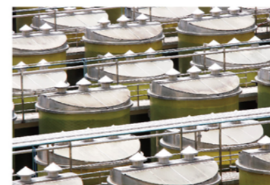
· 新会工厂发酵罐区
